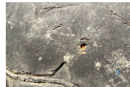
<Nappes métalliques du pneu rouillées>
