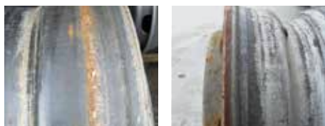
Roue en acier corrodée
