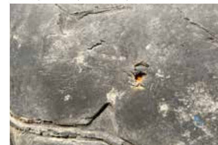
Nappes métalliques du pneumatique rouillées
